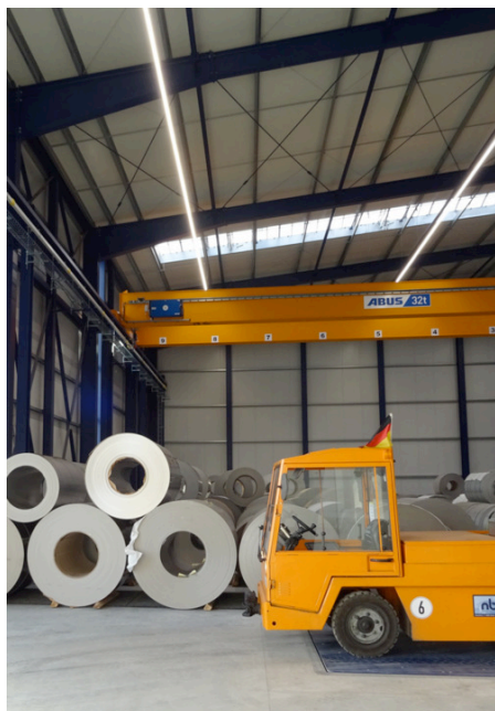
Das neue Hallen-Lichtband "Extrem Power" von Wasco leuchtet Hallen hell, homogen und schattenfrei aus. (Bild: Wasco)
